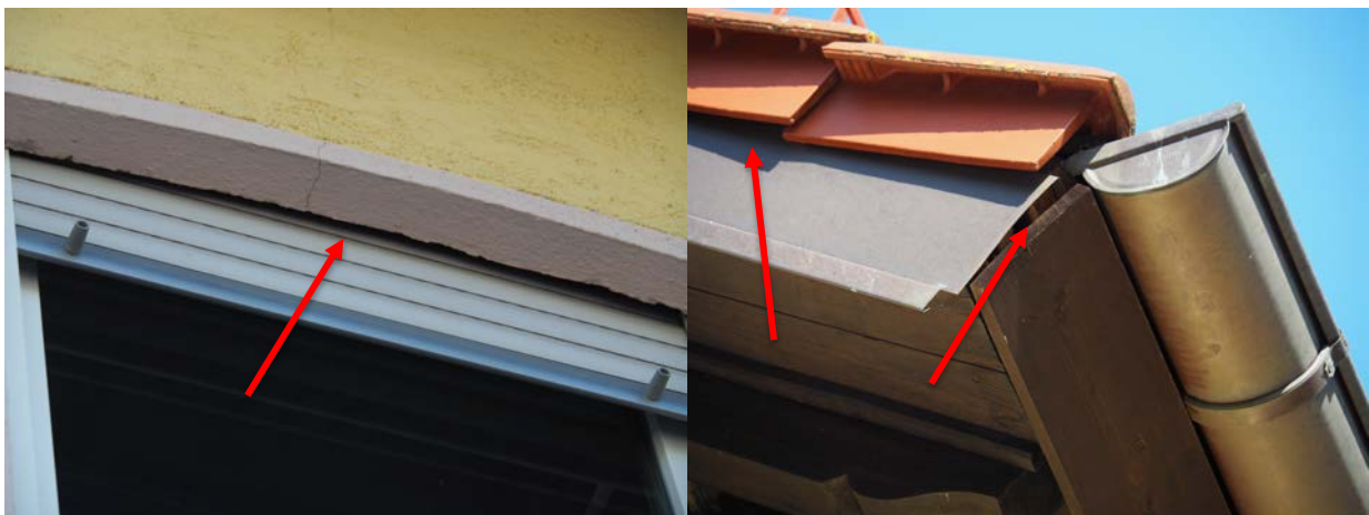
Abbildungen 10 (links) und 11 (rechts): Nachgewiesene Spalten am Bestandsgebäude im Bereich der Rollladenkästen und des Dachgiebels / der Dachtraufe als Einflugmöglichkeiten in potenzielle Fledermausquartiere (Quelle: DRAGOMIR STADTPLANUNG GmbH, Stand 17.08.2023)
